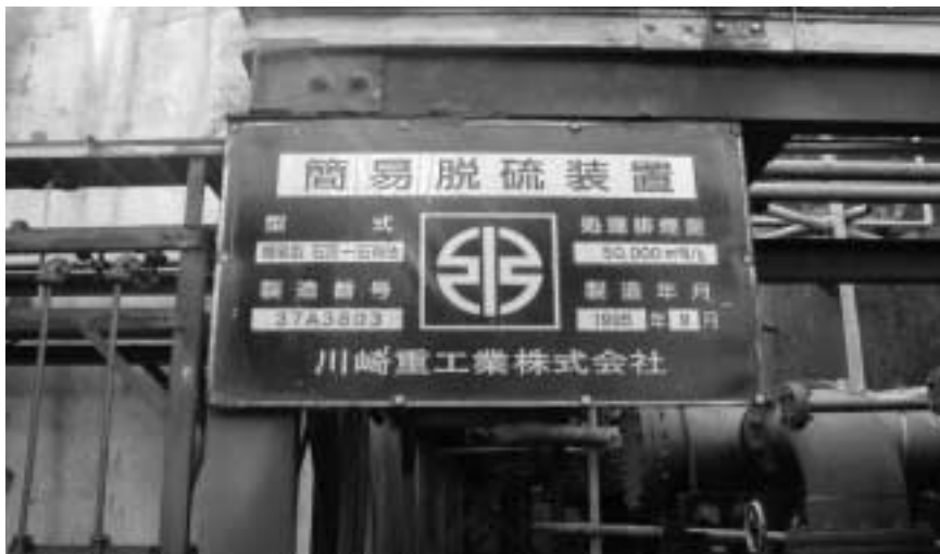
写真3 環境対策をとっている桂林の砂糖製造工場にある脱硫装置
